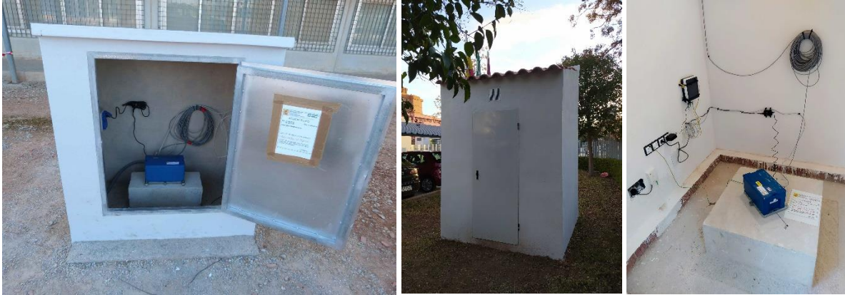
Figura 4: Acelerógrafos instalados en campo libre en Pilar de la Horada, Alicante (izquierda) y Málaga (derecha).
