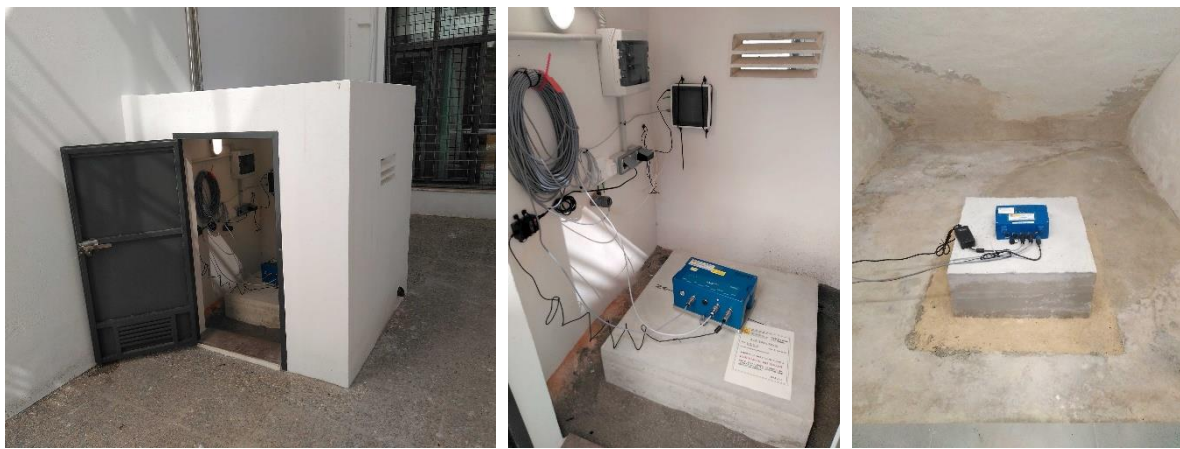
Figura 3: Acelerógrafos instalados en una caseta anexa en edificio municipal de El Ejido (AL) y en un pilar en el sótano en el de Baena (CO)
