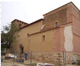
Figura 16. Exterior de San Esteban ya restaurada. Se aprecia la nueva fábrica del muro del presbiterio y las zonas de tap de la fachada sur revocadas. Foto J. Arias
